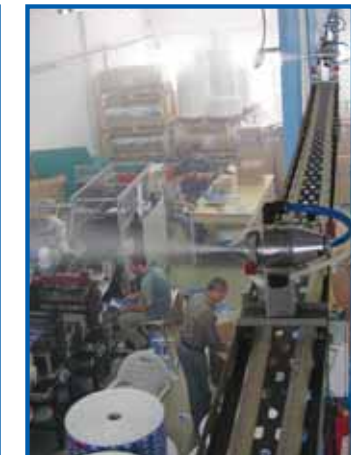
Nozullar tesisat üzerinde
